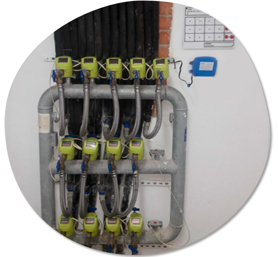
Telelectura NB-IoT no integrada en el contador
